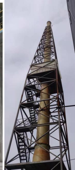
50m 高排气筒 （依托现有工程）
