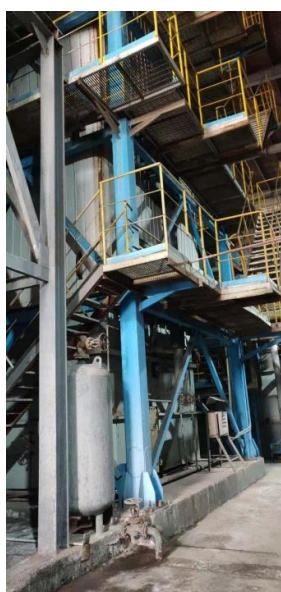
8t/h 余热锅炉
